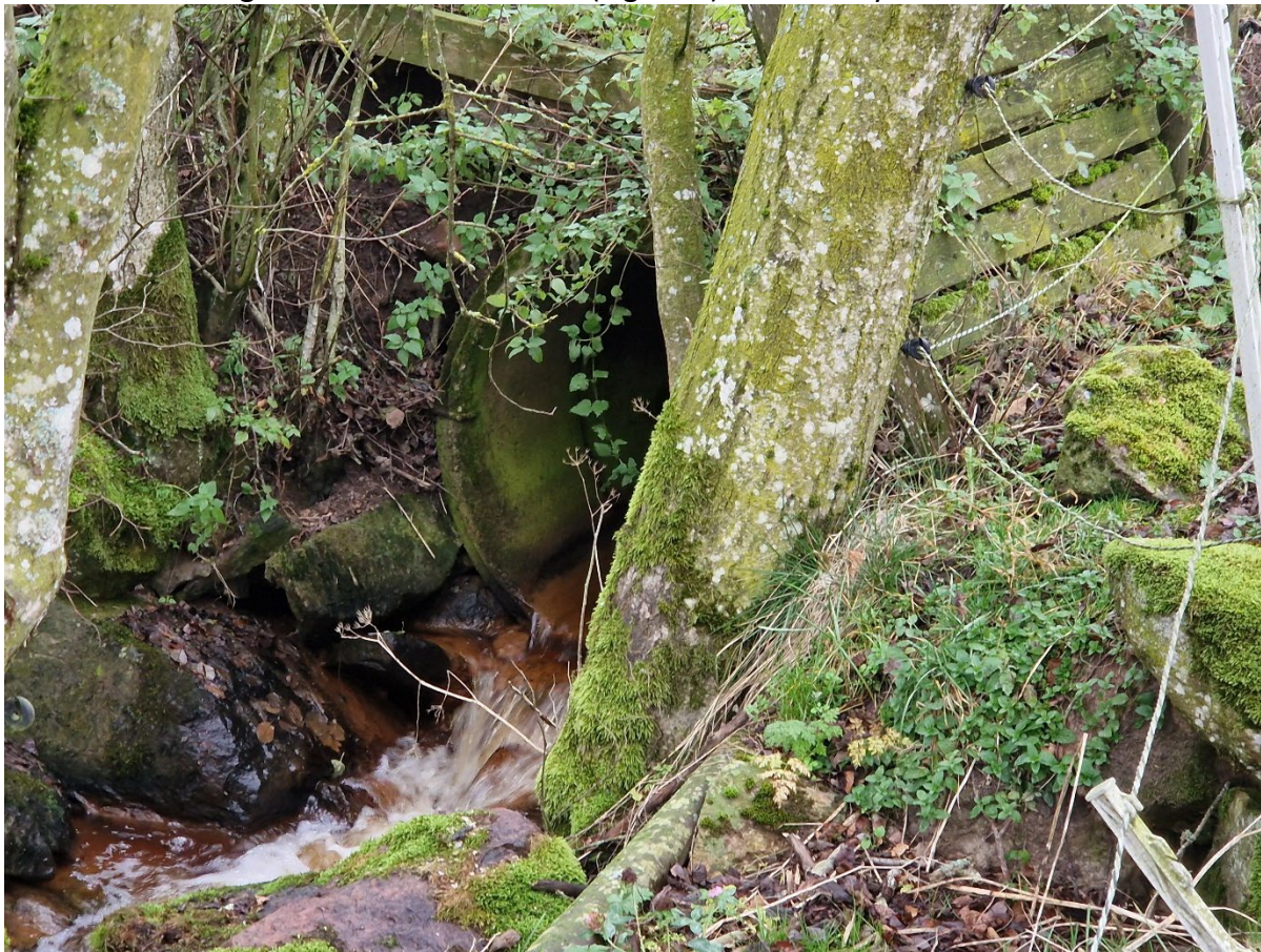
Figur 40. Dåligt lagd vägtrumma i Forsåsbäcken.
